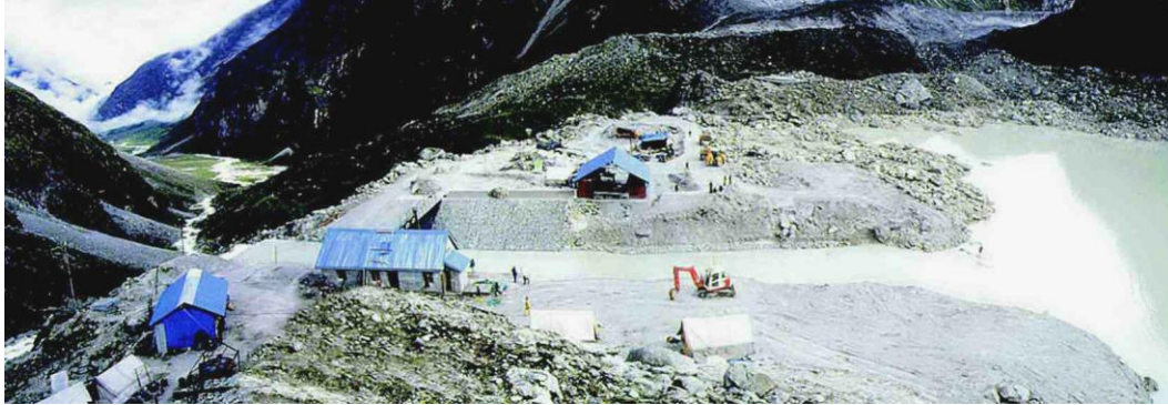
Fot. 6. Sztuczny odpływ oraz śluz, skonstruowane w celu wywołania kontrolowanego wypływu wody z jeziora spiętrzonego wałem morenowym. Tsho Rolpa, Nepal. (Photo: © RGSL 2009)
